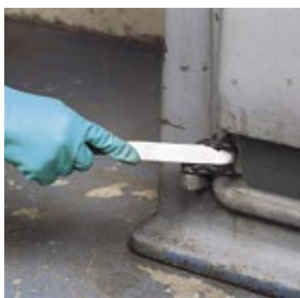
Износостойкий эпоксид имеет хорошую адгезию ко многим металлам и обеспечивает после ремонта гладкую финишную поверхность с низким коэффициентом трения.
