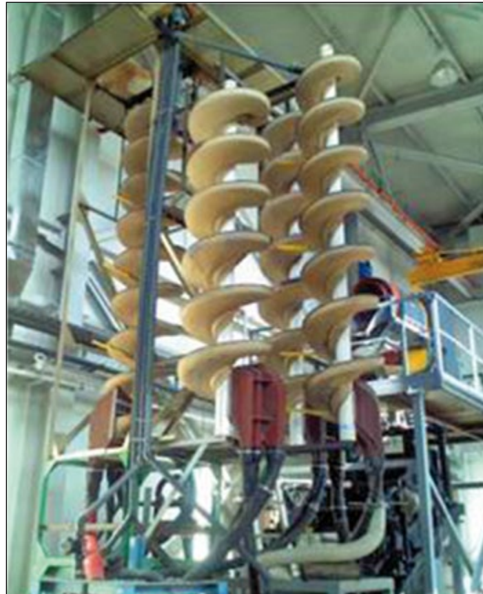
Общий вид батареи сепараторов на производстве.
